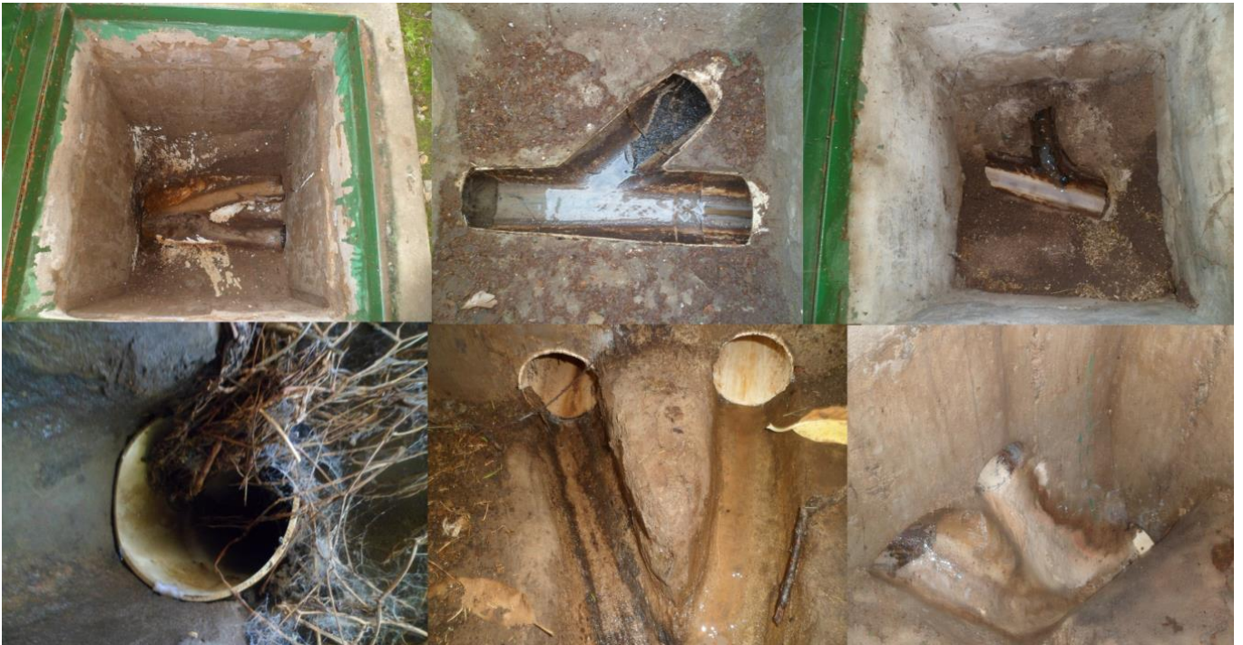
Foto 11: Cámaras de Inspección de la red sanitaria del Campus de la UNGS
