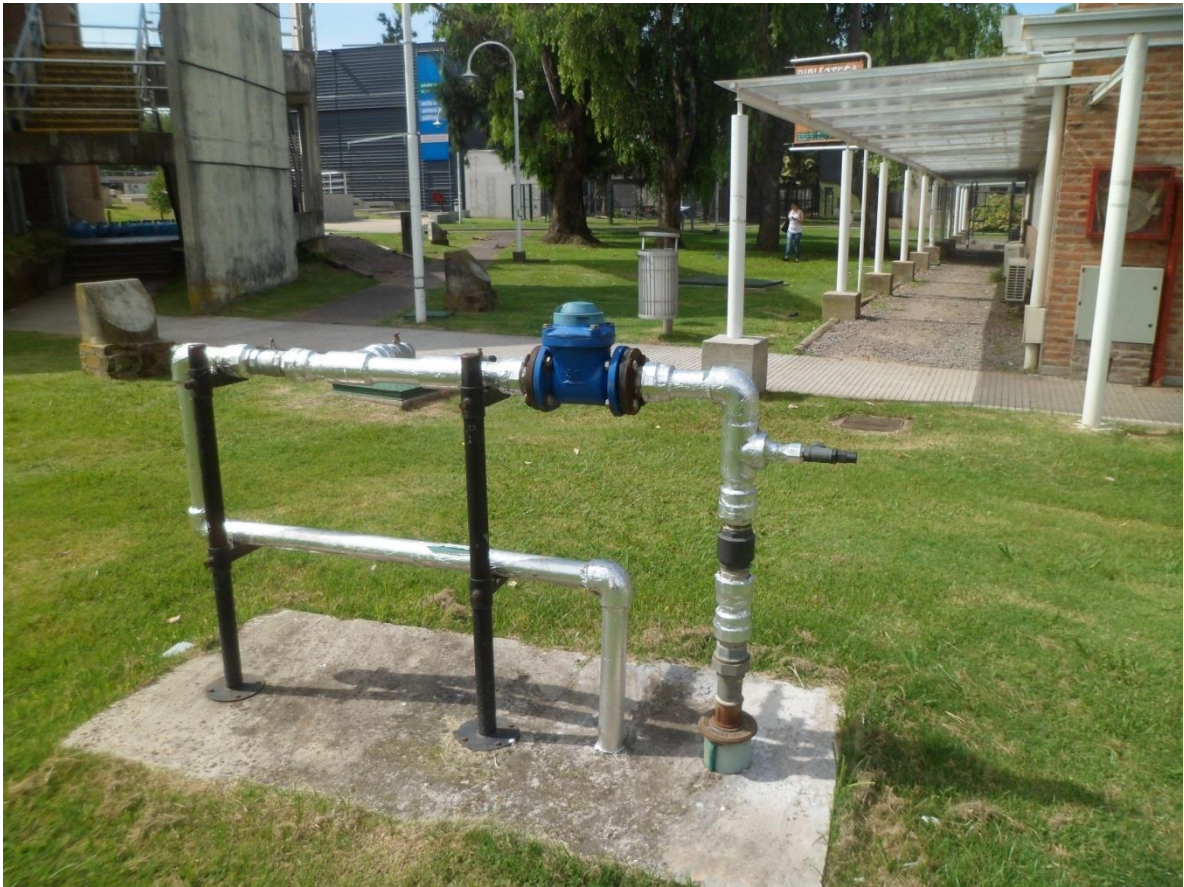
Foto 13: Pozo de extracción fuera de funcionamiento. Febrero 2014
