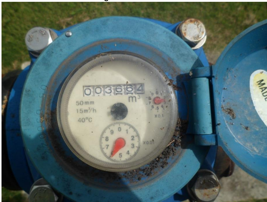
Foto 8: Caudalímetro instalado en el equipo de bombeo del pozo del Sistema 1 de dotación de agua. Febrero de 2014
