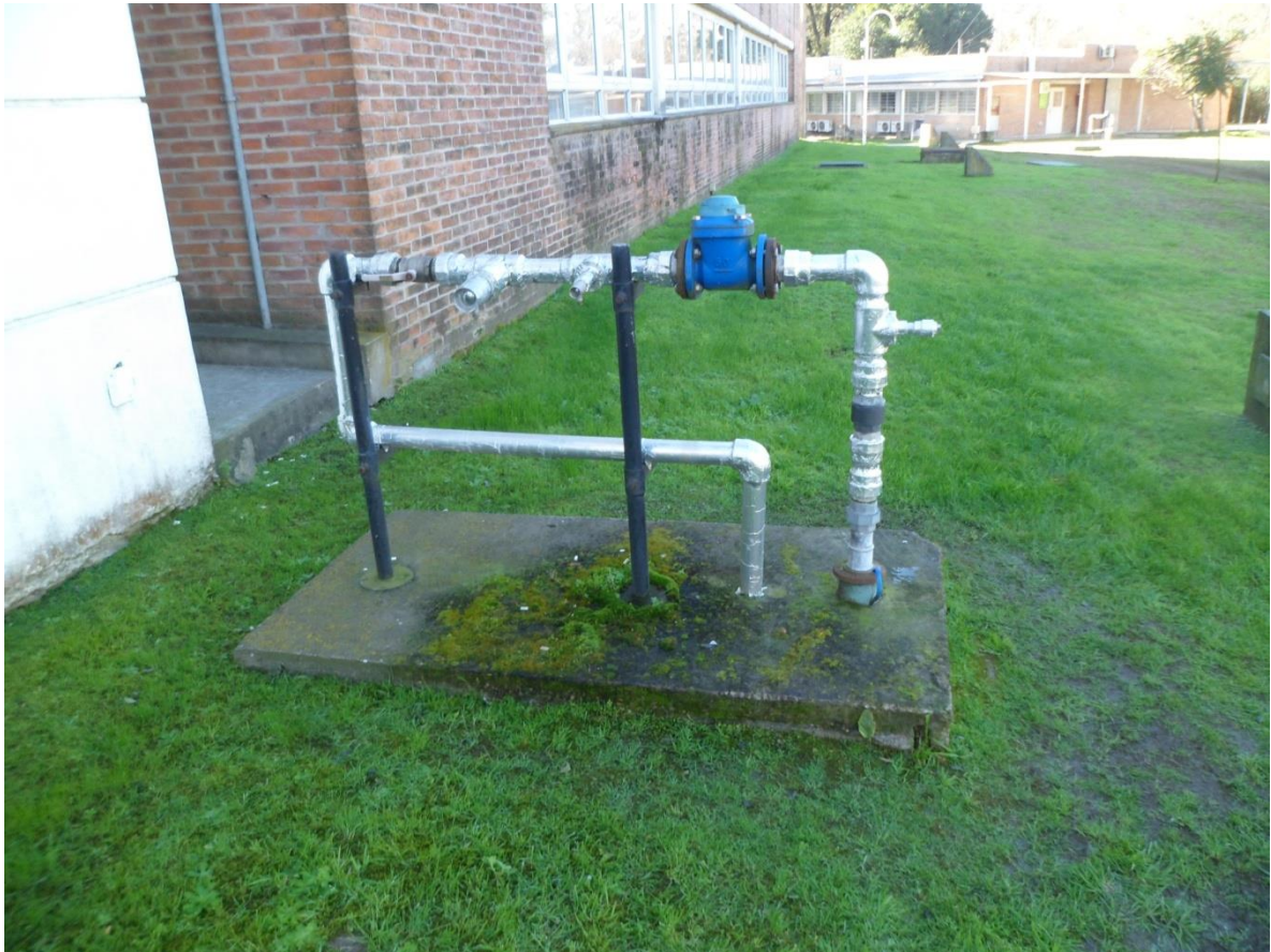
Foto 3: Pozo de extracción del Sistema 1 de dotación de agua (Módulo 1). Febrero 2014
