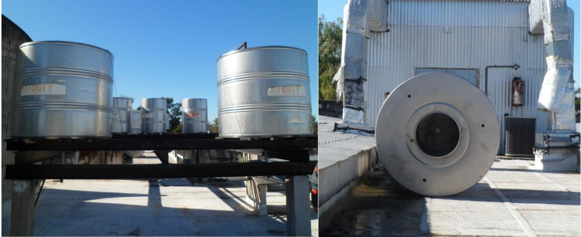
Foto 4: Tanques de almacenamiento y distribución del Sistema 1 de dotación de agua (Módulo 1). Julio 2014
