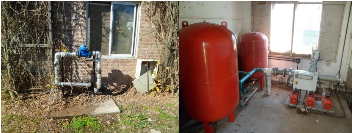
Foto 1: Pozo de extracción del Sistema 2 de dotación de agua (Módulo 7). Julio 2014
